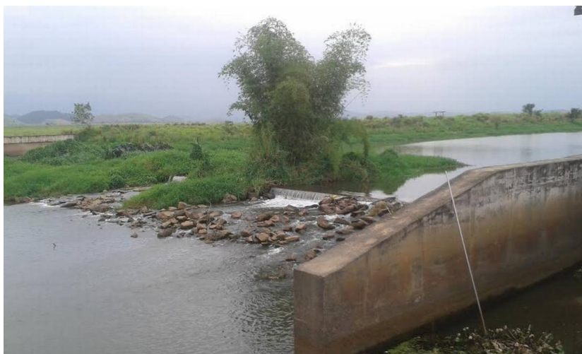
Foto 03 - Mangue. Na barragem de Imunana, com pedras à vista, a baixa vazão do rio favorece a salinização do manguezal ao longo do Rio Macacu Fonte: Divulgação/Paulo Bidegain
